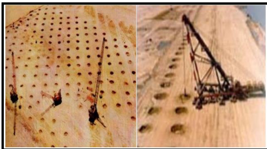
Figure 34 : Réalisation du compactage selon un maillage bien défini (documents de Ménard sol traitement®). [22]
