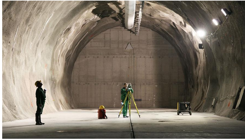
Figure 10 . AUSCULTATION ET SUIVI D'OUVRAGES [27]
